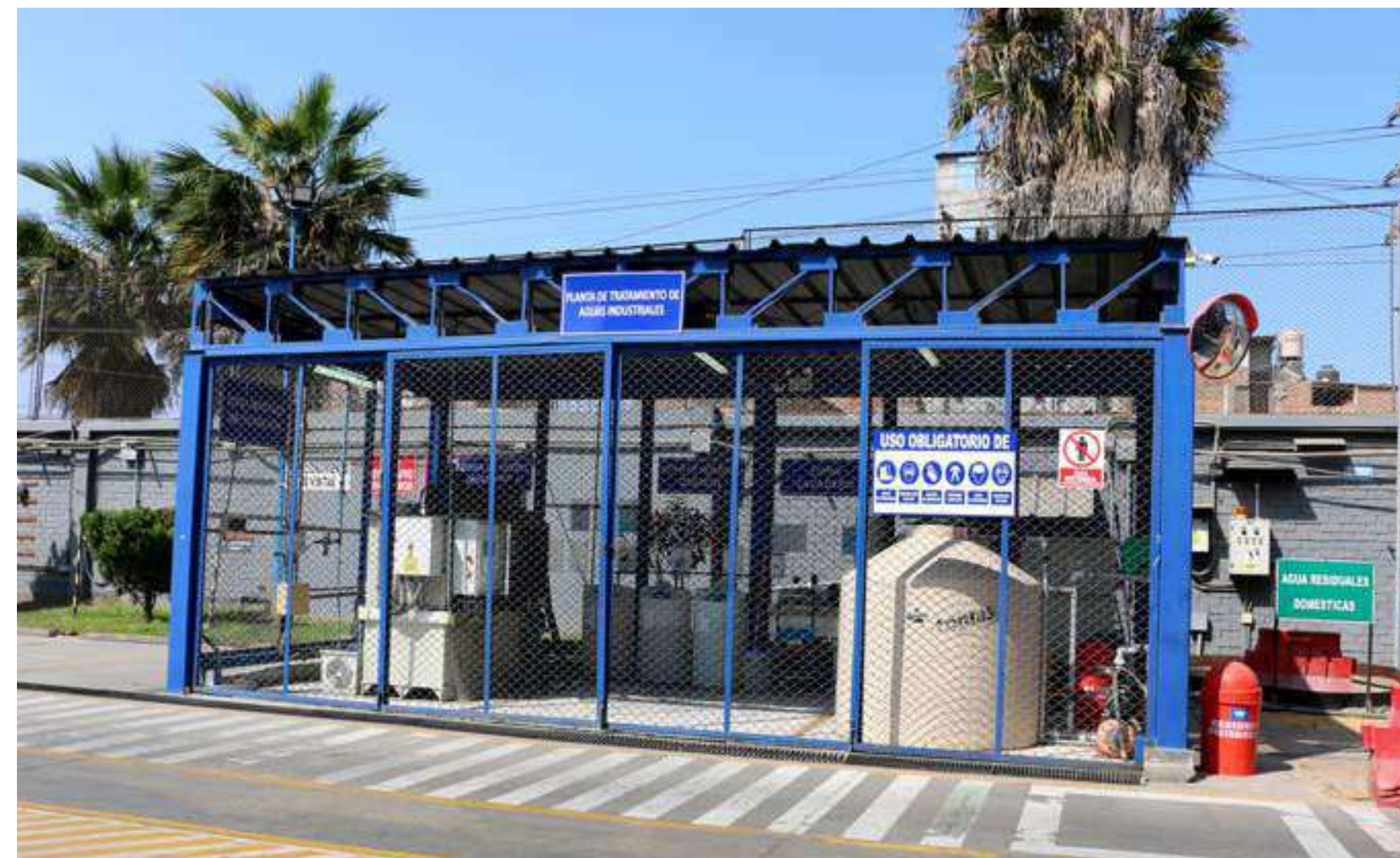
Planta de tratamiento de aguas residuales - Sede Callao
